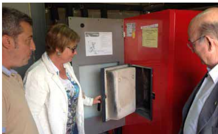
Caldera de biomassa per a xarxa de calor al municipi de Montmajor
